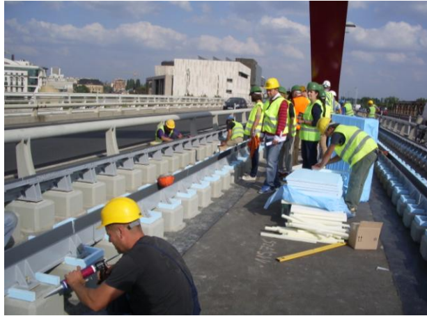
2. kép: A síncsatorna aláöntéséhez zsaluzat-rögzítés a vasbeton magánaljakon. A közút felőli korlátnál a pilon és a ferde rudak védelmére beépített terelőelem is látható.
