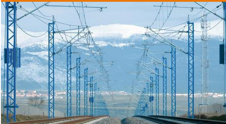
Felsővezetékek nagyvasút hoz
