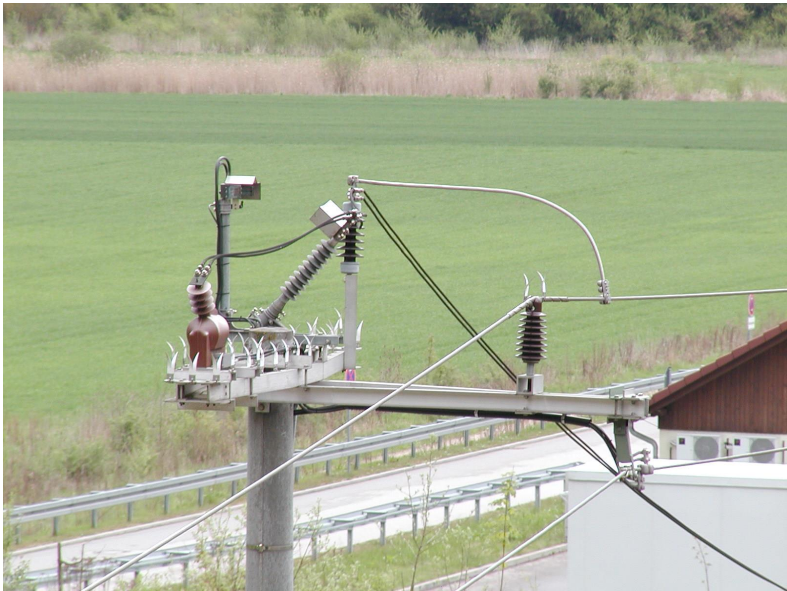
Vákuum megszakító szakaszkapcsoló
