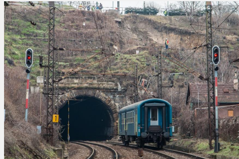
Déli pályaudvari vasúti alagút, rézsűcsúszás, 2015
