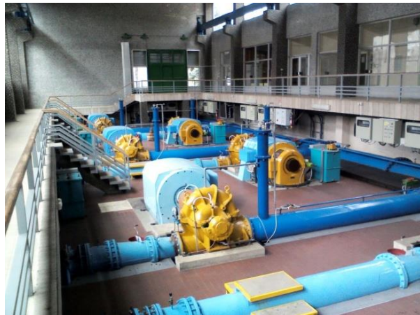
2 db 800kVA-es szivattyú kaszkád hajtás - Fővárosi Vízművek Zrt., Budapest
