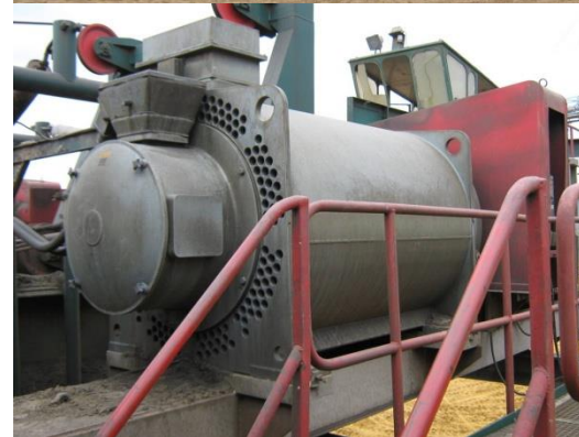
80 db 630kVA-es szállítószalag lágyindító hajtás - Mátrai Erőmű Zrt., visontai és bükkábrányi bánya
