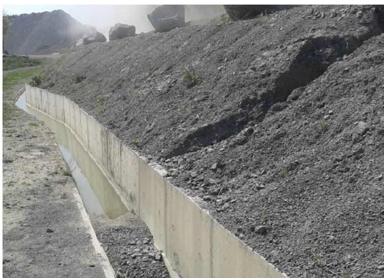
Erőziós károk, vízvezető árkok feltöltődése
