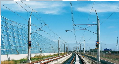
HSL Zuid, Holland Sicat HA 2AC 25 kV
