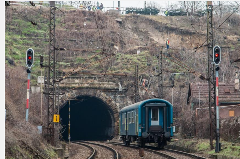
Déli pályaudvari vasúti alagút, rézsűcsúszás, 2015
